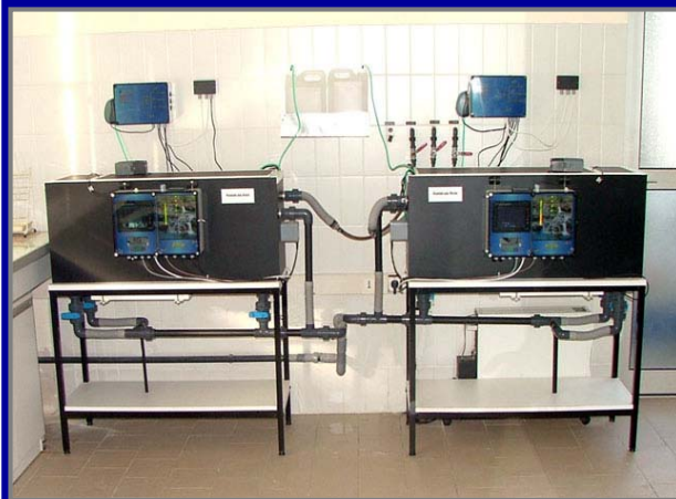
VEOLIA - Station d'Aix en Provence Saint-Eutrope - Surveillance eaux brutes et surveillance eaux filtrées
