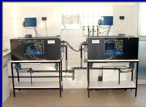
Ici un exemple d'installation de deux systèmes visiolabs : une surveillance eaux brutes et une surveillance eaux filtrées (Station d'Aix en Provence – Saint-Eutrope)
